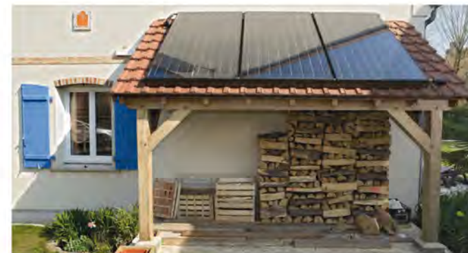
Il est possible de séparer la production d'eau chaude sanitaire et le chauffage : eau chaude solaire et chauffage au bois.
