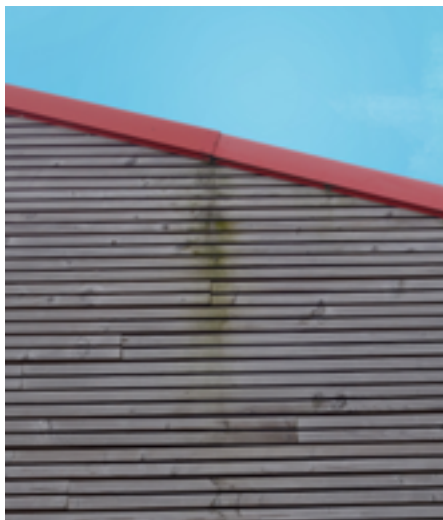
Développement de mousse au droit d'une jonction de rive, créant un écoulement parasite
