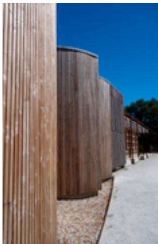
La mise en œuvre d'un sol absorbant (ici une zone basse avec des gravillons) associé à un bardage en conception drainante permet d'éviter des discolorations dues aux eaux de rebond. Médiathèque de Briatexte (81) - 2013 (photo en 2016) - Architecte : Paul-Etienne Gillermin
