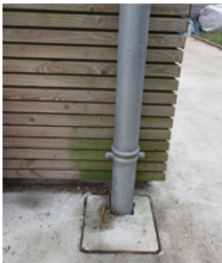
Développement de mousse au pied d'une évacuation d'eaux pluviales indiquant une zone d'humidité
