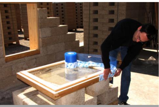
7. Pose du frein vapeur armé (type Contega PV) sur tout le tour de la fenêtre.
