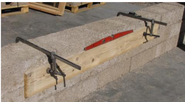
1. Préparation du support à la hauteur de l'appui de fenêtre. Deux planches sont mises de chaque côté et mise de niveau à la bonne hauteur (hauteur d'allège). Elles serviront de guide horizontaux pour la coupe.
