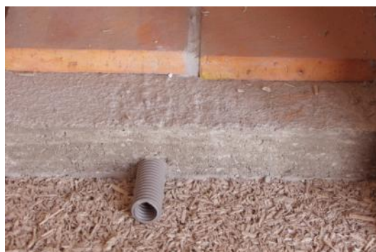
Exemple de carrelage au sol posé sur chape sur bloc de chanvre
