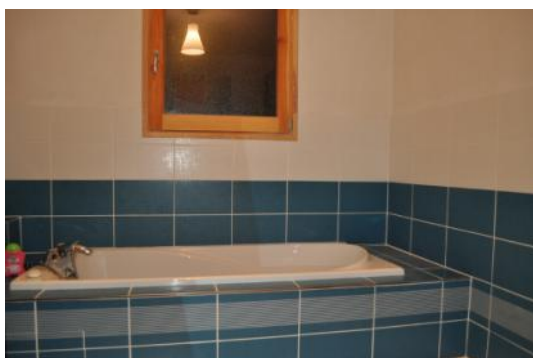
Exemple de faïence posée en salle d'eau sur bloc de chanvre
