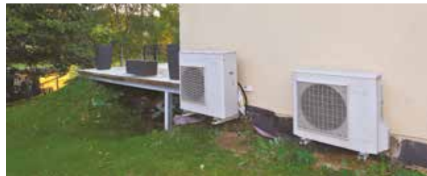
Attention au voisinage, certaines unités extérieures de pompes à chaleur aérothermiques sont plus bruyantes que d'autres.
