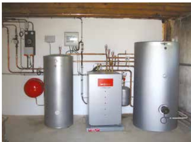
Pompe à chaleur géothermique reliée à un ballon tampon pour le chauffage et à un ballon d'eau chaude sanitaire.
