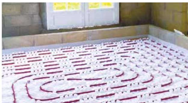
La pose d'un plancher chauffant est assez complexe en rénovation. Il est plus adapté à la construction neuve.
